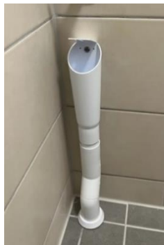
Figur 5 – Vannlås/trakt til vaskemaskin
