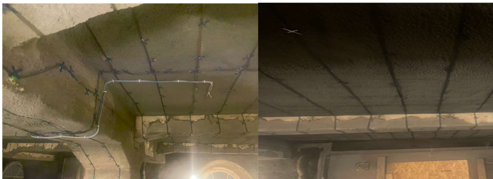
Figur 2 Bildet viser katodisk beskyttelse som er innfelt
